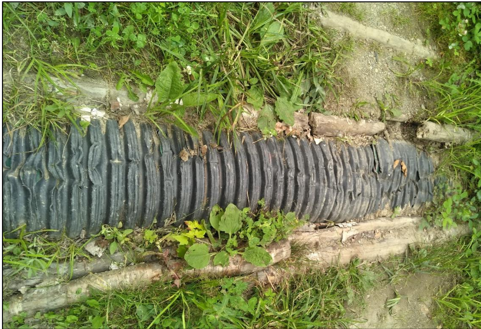
Figure 25. Exemple d'un état critique d'une traverse de ponceau
