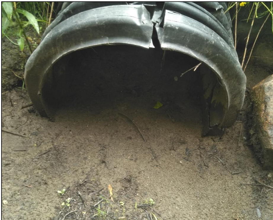
Figure 27. Exemple d'un ponceau obstrué par des sédiments qui limitent l'écoulement de l'eau
