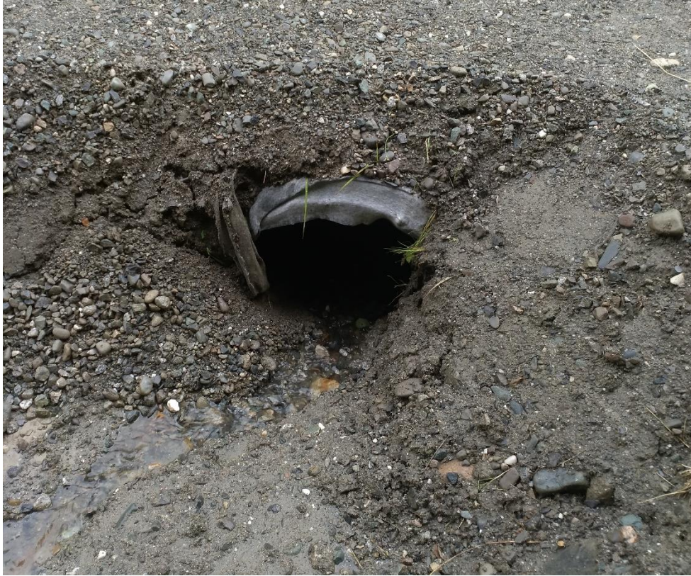
Figure 26. Exemple d'un ponceau mal posé
