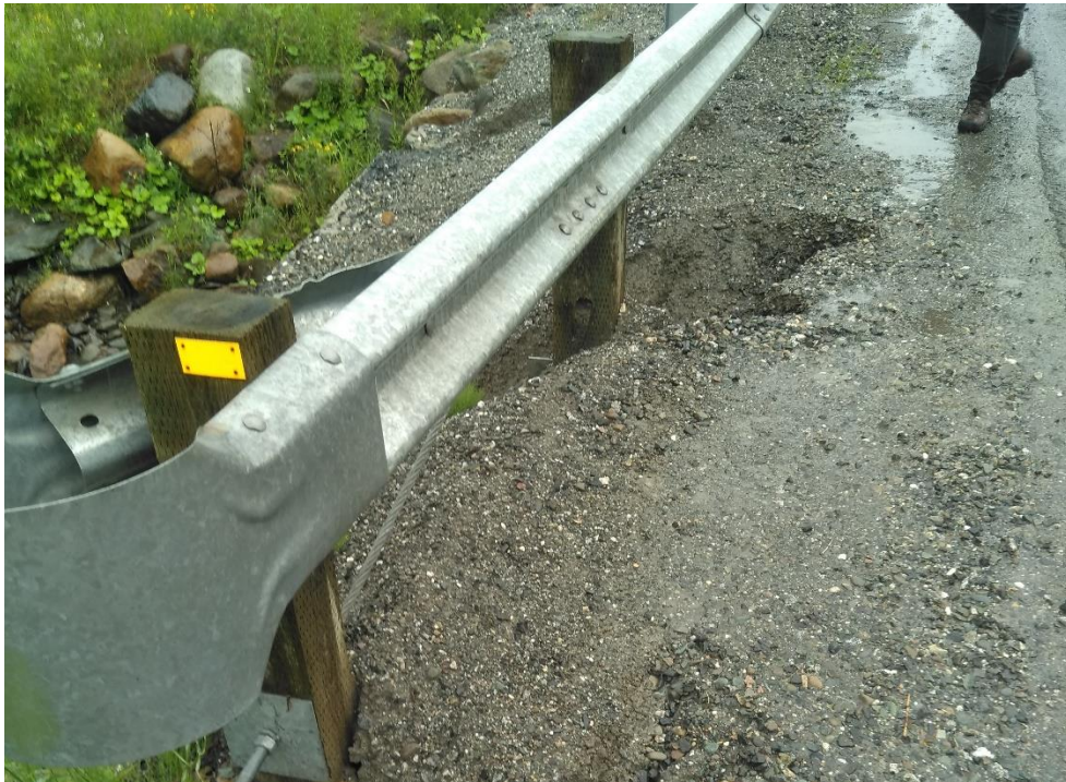
Figure 21. Exemple d'un remblai de pont ou ponceau qui s'érode directement vers le cours d'eau
