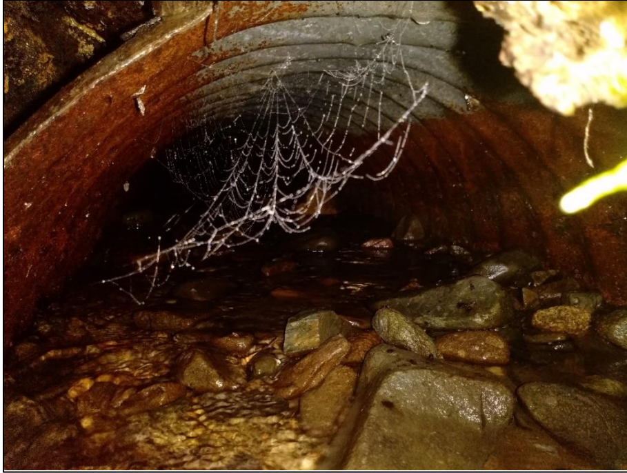
Figure 28. Exemple d'un ponceau bouché qui limite l'écoulement de l'eau et la circulation du poisson
