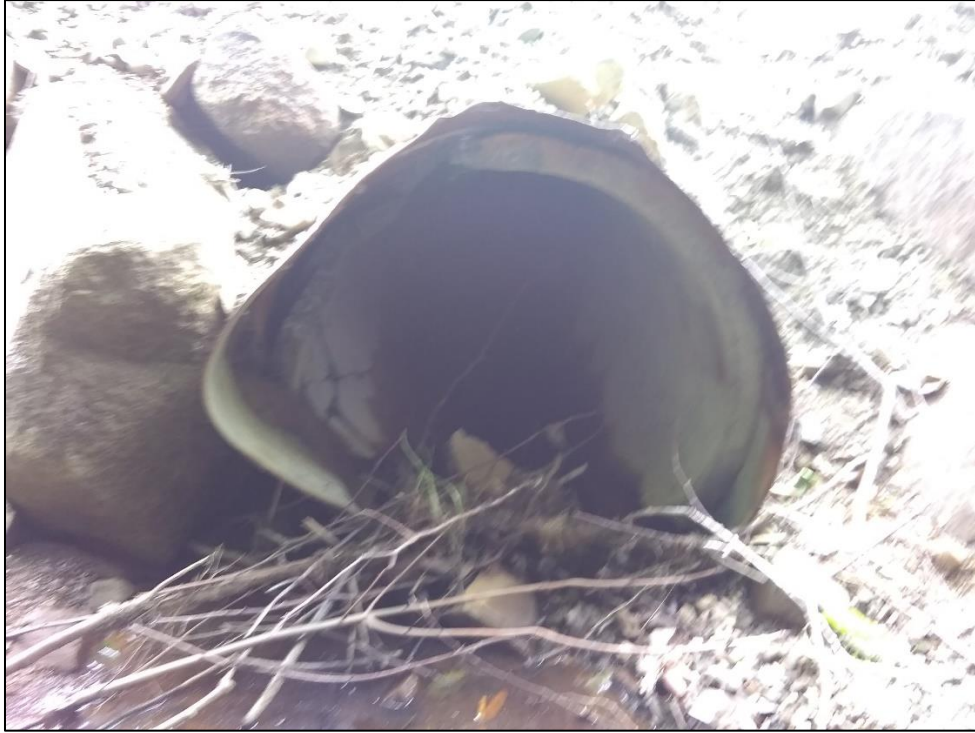
Figure 24. Exemple de ponceau en mauvais état
