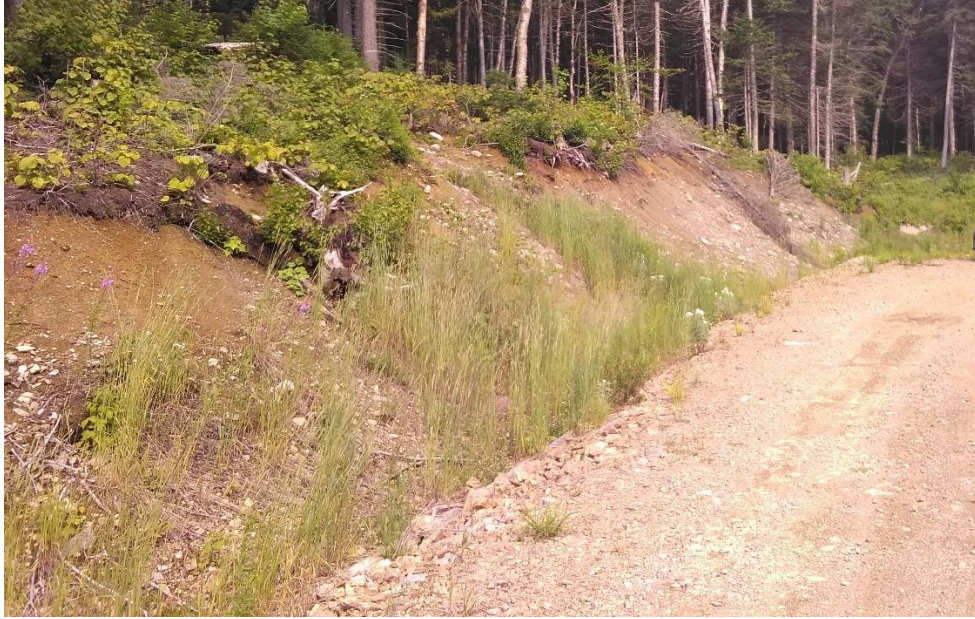
Figure 20. Exemple d'un talus à nu, d'un fossé mal végétalisé et d'un bord de chemin sans végétation
